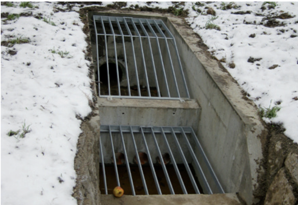
Abb. 32: Räumlicher Rechen am Einlauf zu einer Verrohrung
